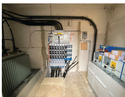
Ensemble du poste
